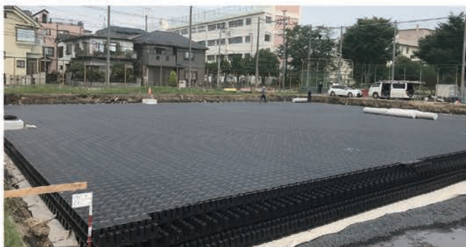
雨水貯留施設（柳崎公園）
